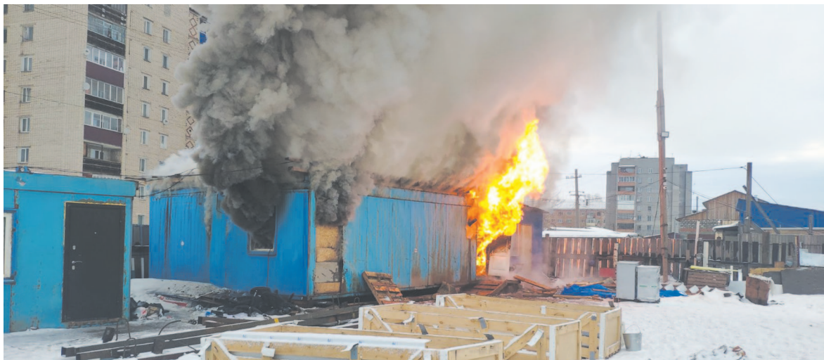
На территории строительства физкультурно-оздоровительного комплекса сгорело здание деревянной бытовки
