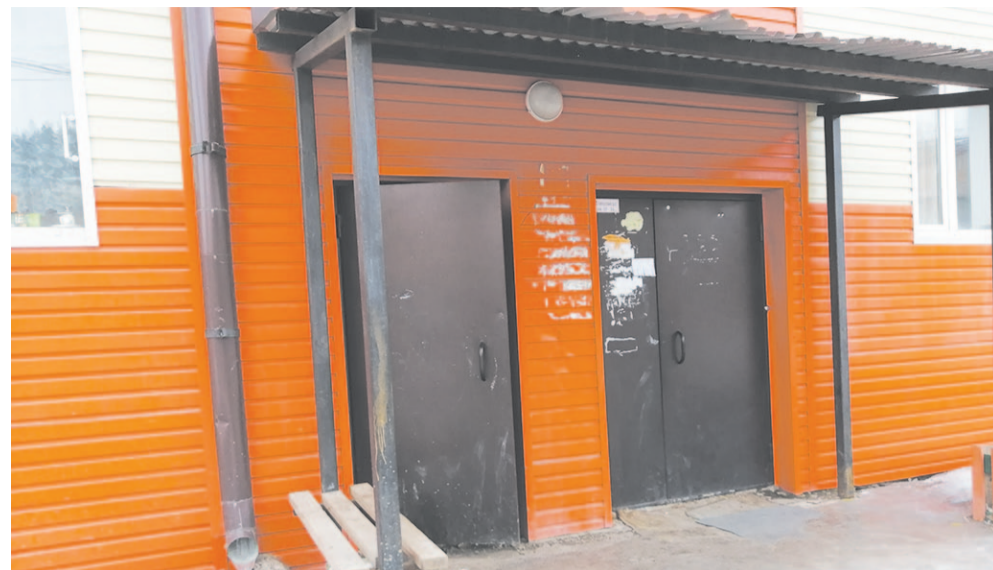
Дом № 85 по ул. Володарского: на фасаде – вмятина, возле подъезда – наледь и мусор, дверь в подвал открыта
