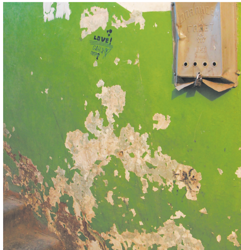
В подъезде дома № 26 по ул. Речников давно не было косметического ремонта
