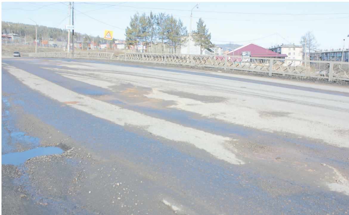
Весной дорожное покрытие превращается в решето
