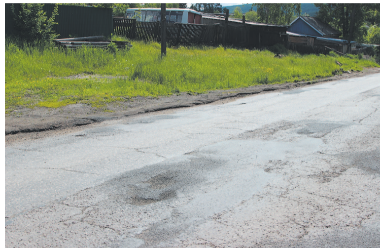
На месте выбоин, отремонтированных с помощью технологии пневмонабрызга, начинают появляться новые
