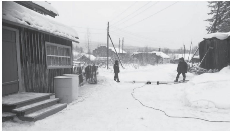
В посёлке Артемовском Бодайбинского района вторую неделю устраняют последствия аварии на теплотрассе.
