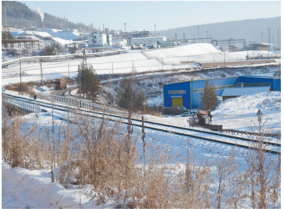
Зона строительства трассы «Виллой» на выезде из Усть-Кута затрагивает интересы двух крупных предприятий: Иркутской нефтяной компании и ООО «Транс-Сибирская лесная компания», – чьи территории примыкают к ней.
