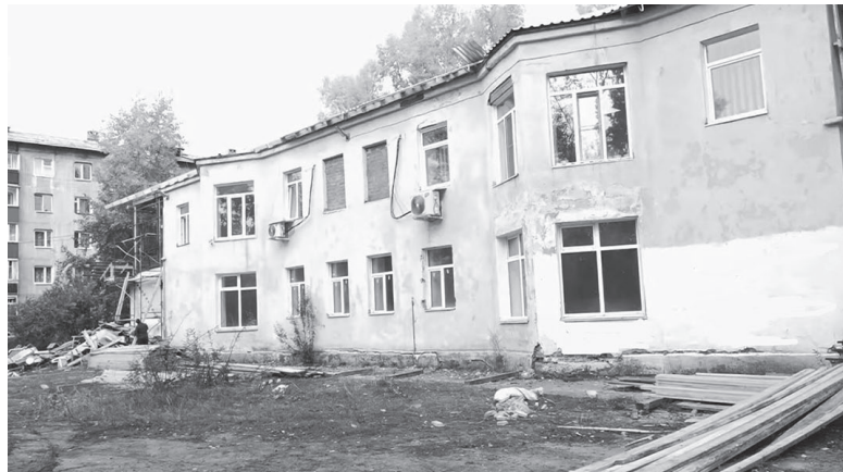
Ремонтные работы планируется завершить в следующем году. По плану здесь заработает молодежный центр, где будет много площадок для воплощения идей устькутян.
