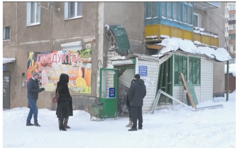
С крыши здания по ул. Пушкина, 60 сошла глыба снега.
