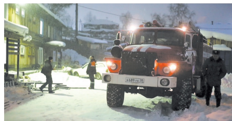
Перемерзшие трубы отливали горячей водой с помощью пожарных машин.
